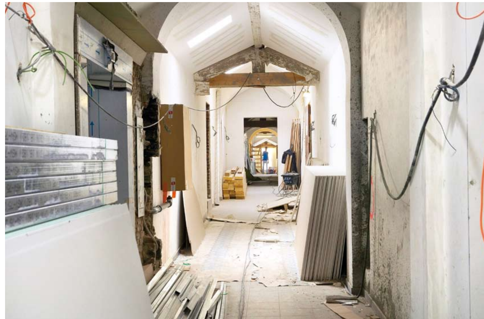
Grondige restauratiewerken op de vierde verdieping van 'de 16' voor o.m. de nieuwe zaal voor de Ministerraad.
